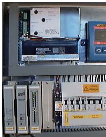
Bild 1: Außenstation mit Unterbrechungsfreier Stromversorgung (USV)
