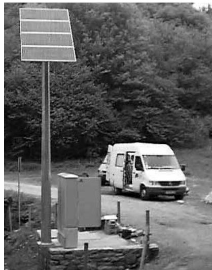
Bild 4: Solaranlage für REDAS 4.
