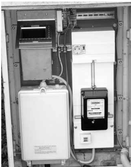
Bild 3: REDAS 4, nachgerüstet in bestehenden Freiluftschaltschrank.
