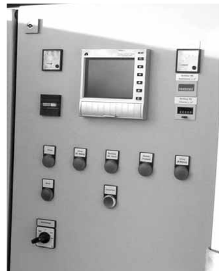
Bild 2: Bildmitte: REDAS 4 mit Diskettenlaufwerk im Freiluftschaltschrank.
