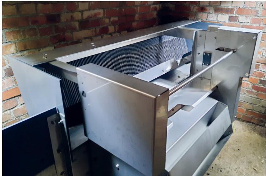
Bild 3: GiWA-Rechen in einem Bestandsbauwerk, Blick von der Entlastungsseite. An der linken Seite überbrückt eine Stauplatze die verbleibende Schwellenlänge.
