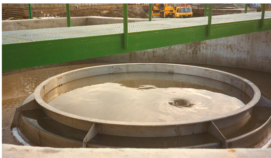
Bild 2: Wirbelabscheider während eines Überlaufereignisses. Das Wasser strömt durch den Ringspalt auf den Deckel aus.
