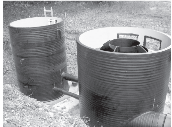
Bild 4: Wirbelabscheideranlage aus zwei PE-HD-Fertigteilen (links der Drosselschacht)
