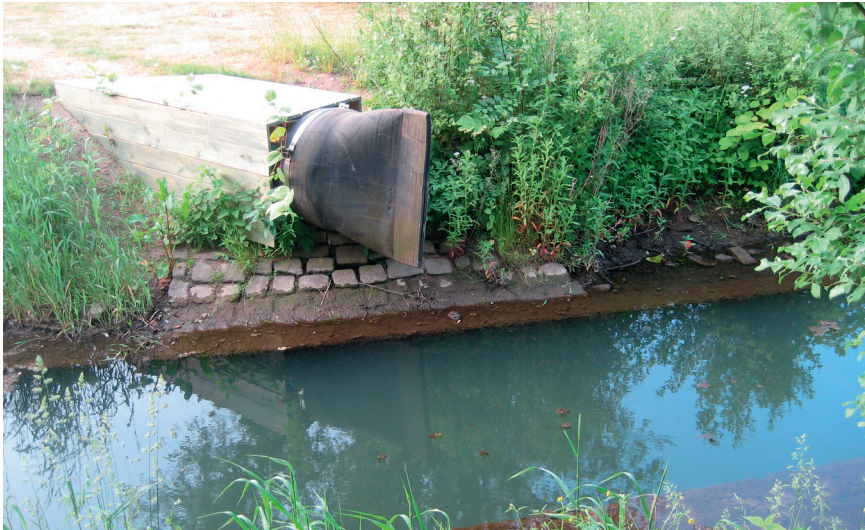
Bild 1: Rückstauventil UFT-FluidFlex, eingebaut als Rückstauschutz am Auslauf einer Freispiegel-Entlastungsleitung. Die freiliegende Leitung wurde hier aus Gründen der Optik mit gehobelten Brettern verkleidet.
