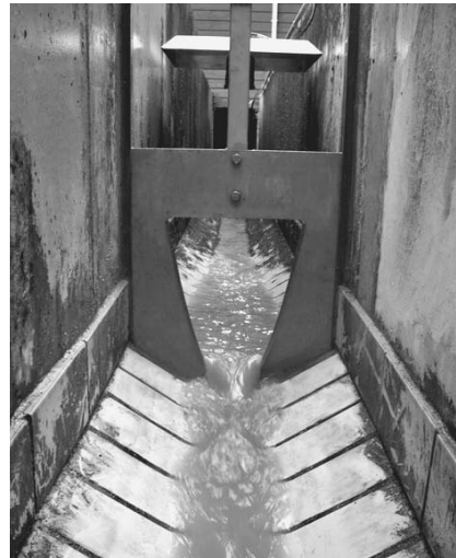
Bild 2: Nachgerüstete Parabelmessblende DN 200 in einem Kläranlagenzulauf. Die Ultraschallsonde für die Wasserstandsmessung ist an der Messblende befestigt und mit einem Schutzdach abgedeckt.
