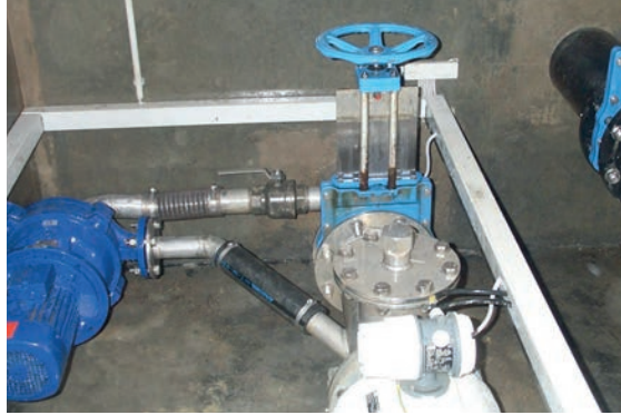
Abwasserleitung mit geeichtem Durchflussmesser und Boosterpumpe zur Vermeidung von Ablagerungen
