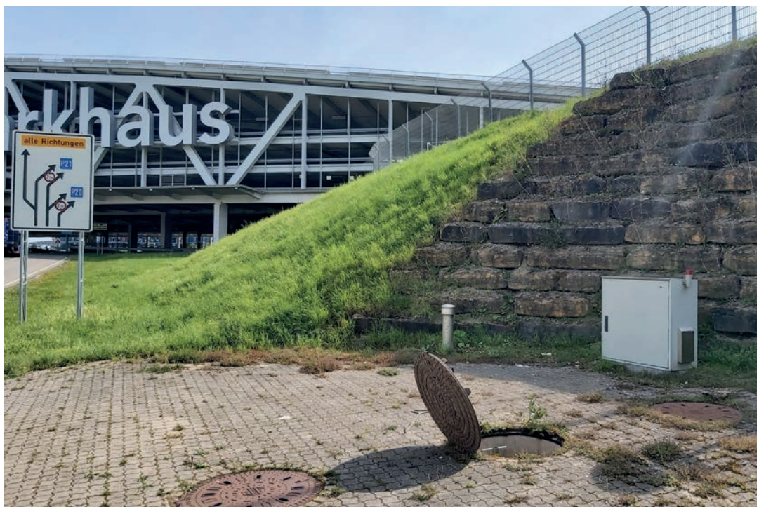
Der Einstieg zum unterirdischen Messschacht und der Freiluftschrank mit Steuerung
