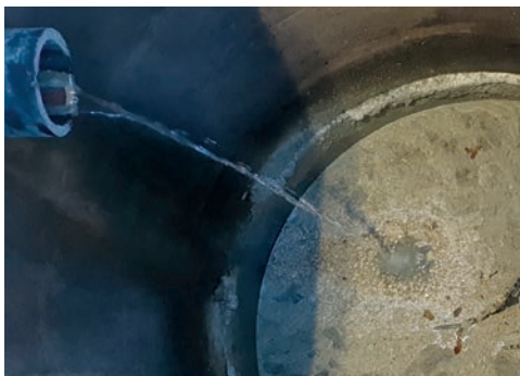
Eine Fettschicht schwimmt im Pumpenschacht
