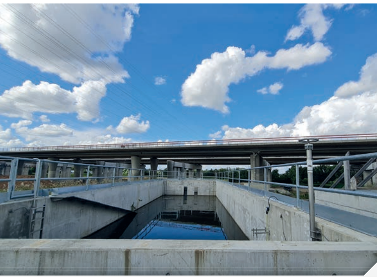
Mit der neuen Brücke wird auch gleich das Klärbecken für den Straßenablauf gebaut (am linken Beckenrand eine Amphibienausstiegshilfe)
