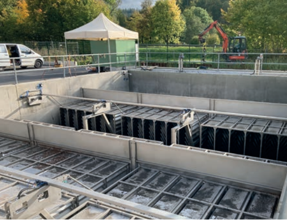
Großes Regenklärbecken mit Kreuzstrom-Schräglärern zur Steigerung der Sedimentationsleistung
