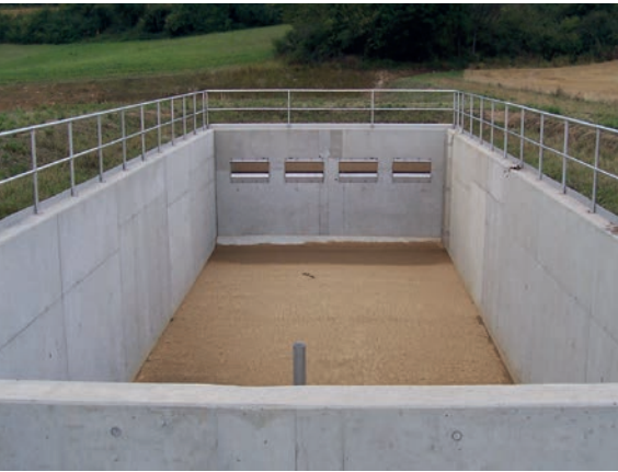
Klassisches Regenklärbecken in Betonbauweise mit vier Klärüberläufen in der ablaufseitigen Stirnwand zur Begrenzung des Durchflusses
