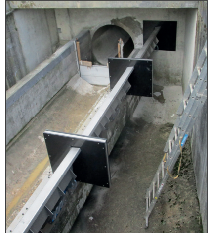
Federstauklappen, Blick zum Zulaufkanal
