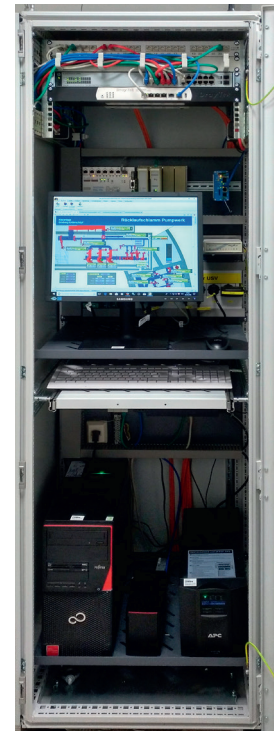
Bild: Zentraler Server-schrank der Kläranlagen-IT-Infrastruktur
